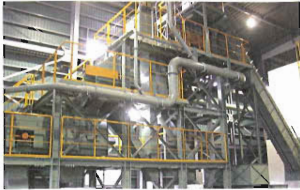
レアメタル・貴金属濃縮回収設備
